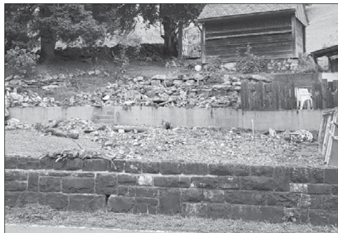
Abbildung 1: Übersarung und Geschiebeablagerung Hochwasser 2021, Geissbergbach oberhalb Dorfstrasse
